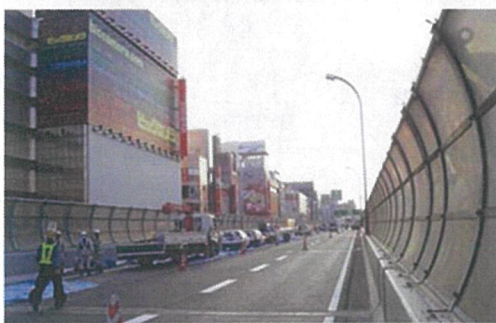
地 域：大阪府 阪神高速道路 件 名：15 号 リフレッシュ工事 施工時期：平成 19 年 10 月 内 容：SJ-M 型（横目地） 交 通 量：58,100 台/日 センサス調べ
