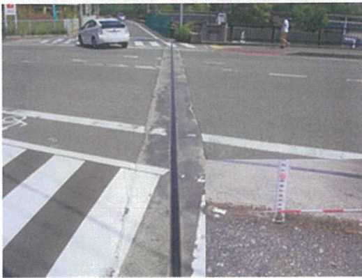
写真① (施工後約5年)
