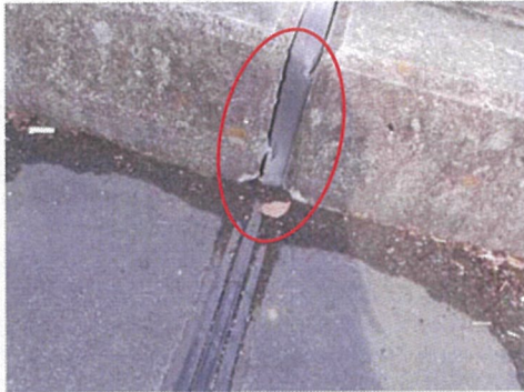
地覆シールの損傷
