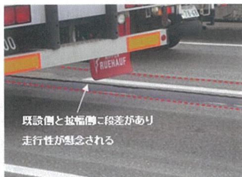
既設橋と拡幅橋の段差発生
