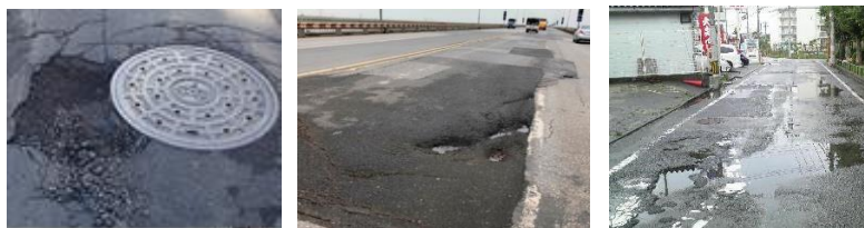
繰返し補修箇所・マンホール
