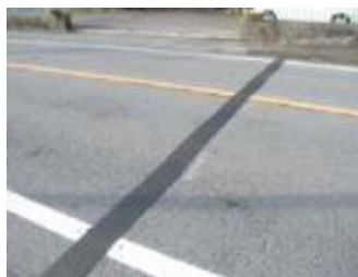
クラック補修
