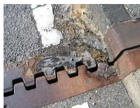
フェイスプレートの錆 ・断面欠損 (フィンガージョイント)
