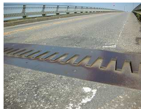
段差 (フィンガージョイント)
