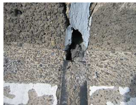
経年劣化 変色・割れ・硬化 (地覆シール)
