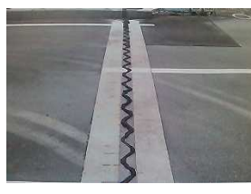
止水シール材の 路面へのはみ出し
