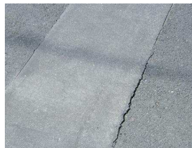
舗装と特殊合材 との剥離 (埋設ジョイント)
