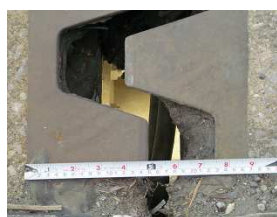
止水材の脱落
