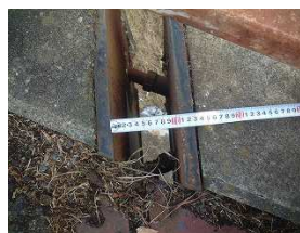
止水処理無し (地覆シール)
