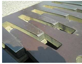
段差 (フィンガージョイント)
