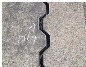
止水ゴムの剥離 鋼板表面の錆・変形
