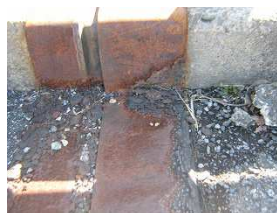
フェイスプレートの錆 ・断面欠損 (スライトジョイント)
