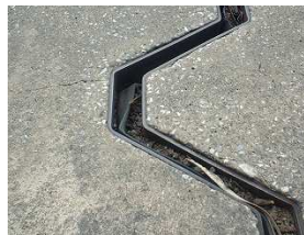
止水ゴムの剥離
