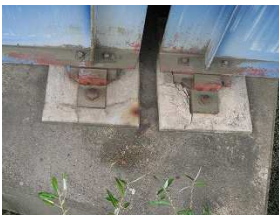
杓座モルタルの割れ
