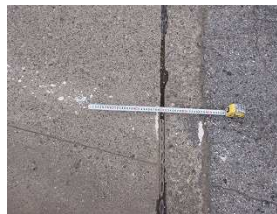
目地ジョイント部の 目地材の落ち込み
