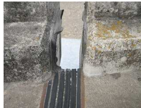
脱落 (地覆シール)
