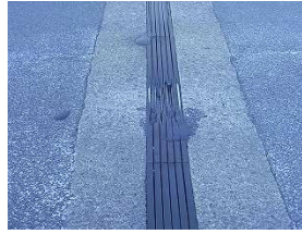
部分欠損 (ゴム)
