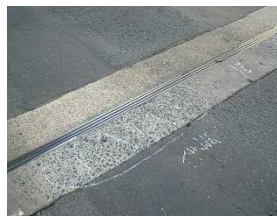
後打ち材の浮き (手前側)
