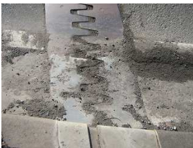
土砂づまり (フィンガージョイント)
