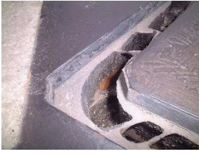
シーリング材の割れ 亀裂
