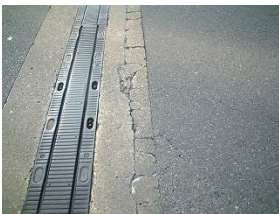
後打ち材のひび割れ
