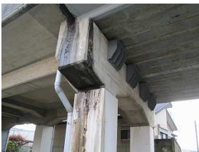
橋脚漏水痕 (下部より)
