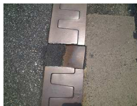
亀裂・爪折れ (フィンガージョイント)
