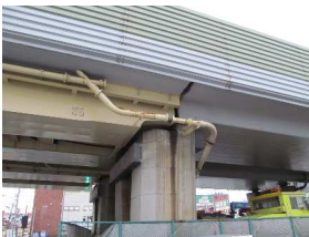
掛け違い部 (漏水痕)
