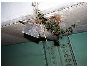
桶の損傷・脱落 (フィンガージョイント)
