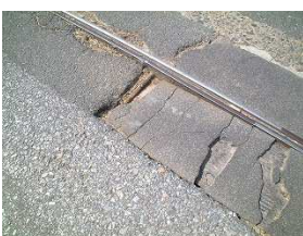
後打ち材の損傷
