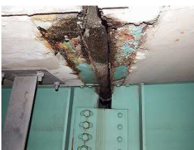
下フランジの錆と 断面欠損 (フィンガージョイント)
