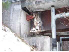
漏水と塩害による 桁および支承の錆 (耐候性鋼板桁)
