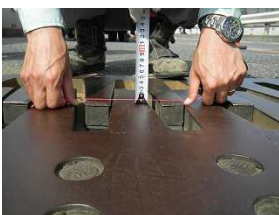
段差 (フィンガージョイント)
