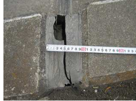
切れ (地覆シール)
