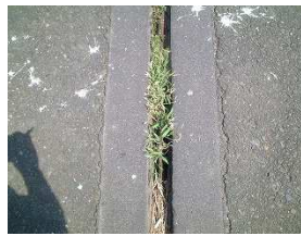
止水ゴムの脱落
