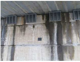
橋台漏水痕 (下部より)
