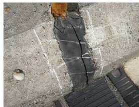
切れ (地覆シール)
