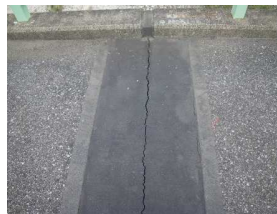
特殊合材のひび割れ (埋設ジョイント)
