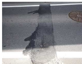
埋設ジョイント のダレ・流動 轍掘れ (埋設ジョイント)
