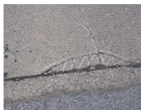
目地ジョイント部 コンクリートの割れ
