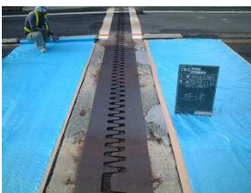
後打ちコンクリートの 損傷 (フィンガージョイント)
