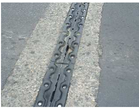
荷重支持板の欠損
