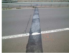
ジョイント近傍 の舗装割れ バインダーの擦り減り (埋設ジョイント)
