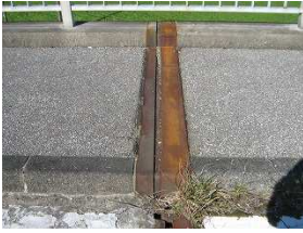
フェイスプレートの錆 (スライトジョイント)
