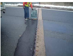
部分欠損 (半車線)
