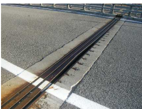
モジュラー形式 伸縮装置の損傷 ビームの曲り
